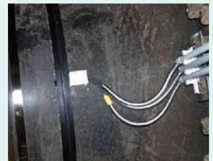
Telemetrie auf der Treibscheibe
